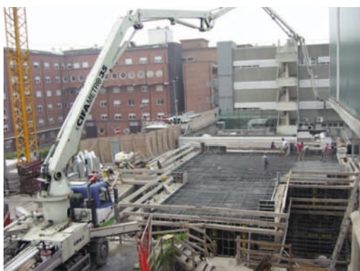
Bunker - Nuovo acceleratore lineare - Ospedale di Mantova
